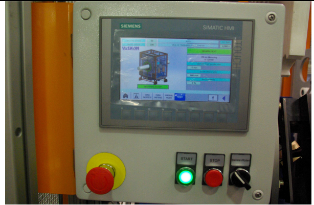
Operator panel (Siemens)
